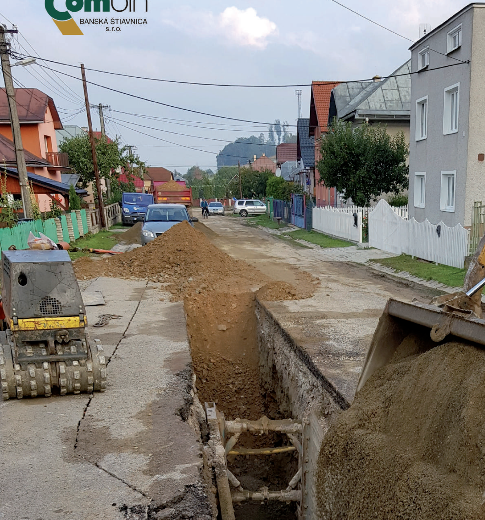
Pohronská Polhora - kanalizácia
