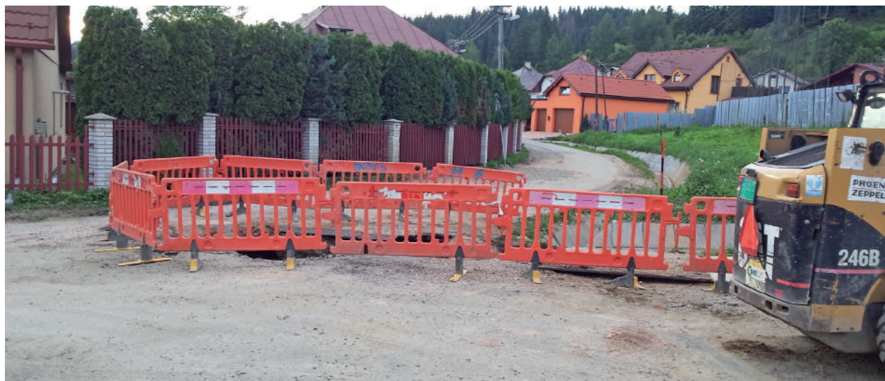
Pohronská Polhora - kanalizácia
